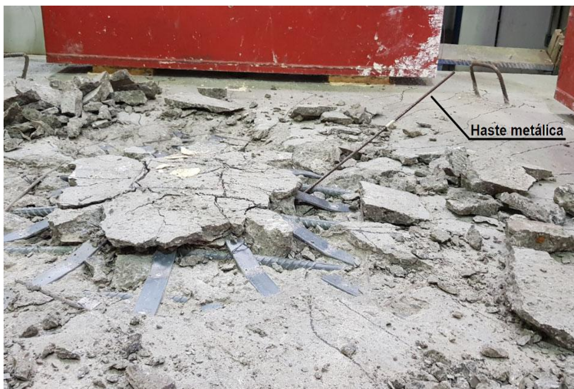
Figura 4.6: Medição aproximada do ângulo da superfície de ruptura de laje com armadura de cisalhamento – Laje L50C.
