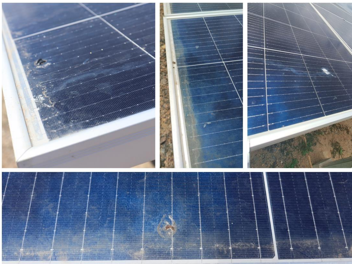
Figura 5.15: Registro da sujeira dos painéis.
