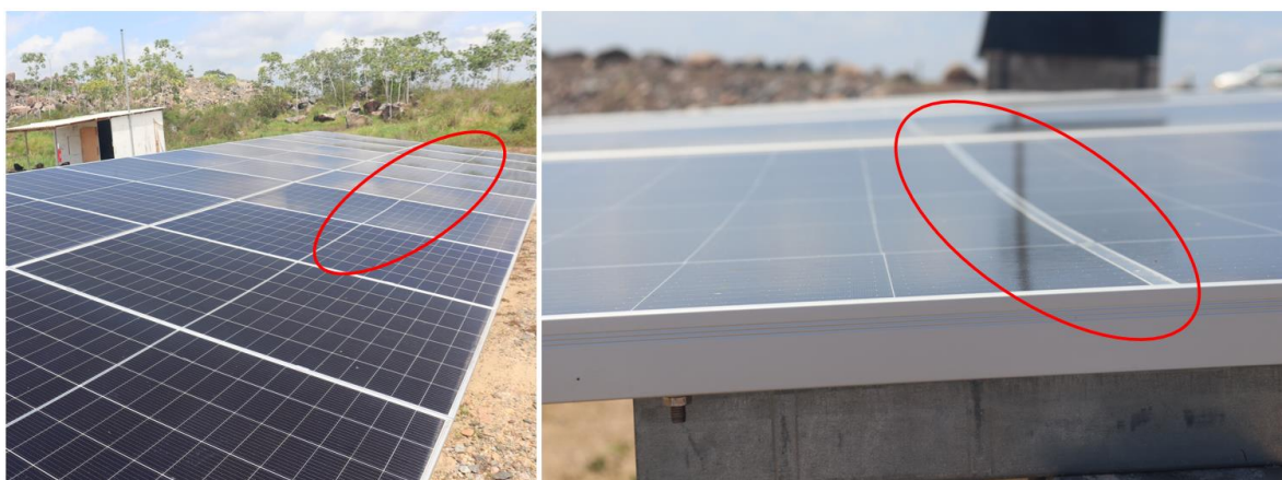
Figura 5.16: Identificação da deformação/curvatura dos módulos bifaciais
