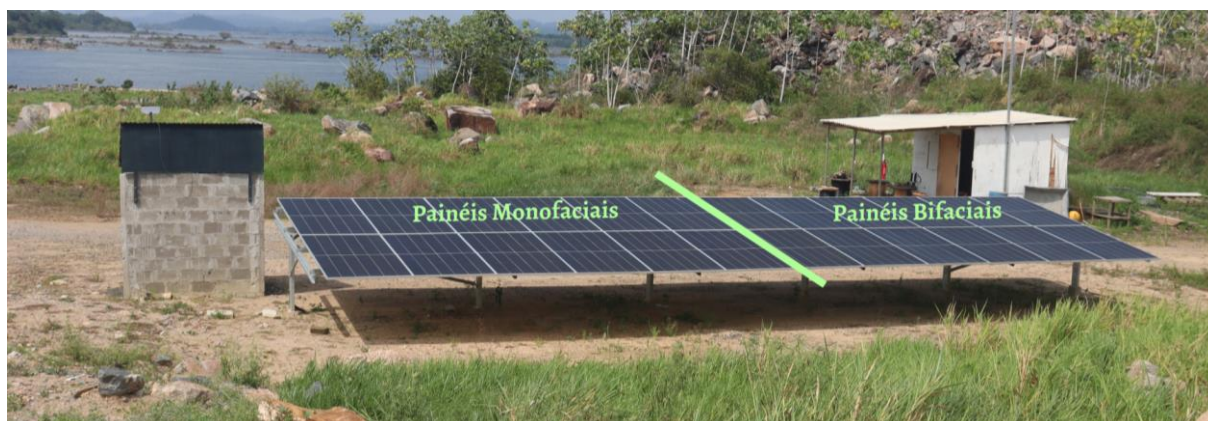
Figura 5.7: Distinção entre os painéis monofaciais e bifaciais da planta fotovoltaica fixa
