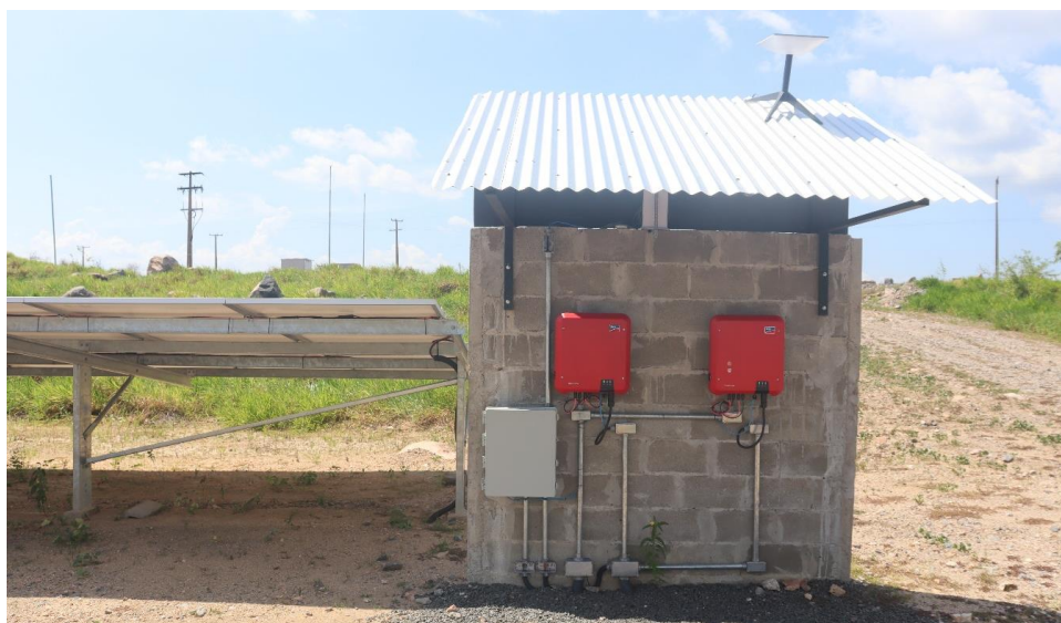
Figura 5.8: Inversores (em vermelho), sistema de comunicação das plantas fotovoltaicas e antena do sistema de internet via satélite Starlink
