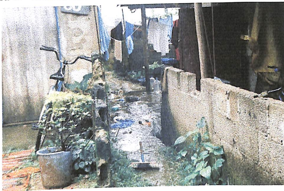
Figura 16 - Falta de escoamento pluvial e entupimento de caixas de contenção
