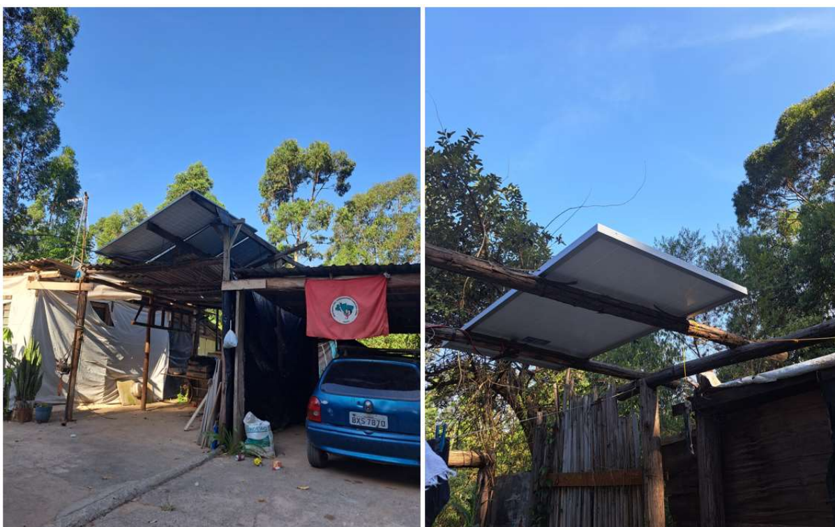
Figura 51 - Placas fotovoltaicas instaladas em alguns barracos
