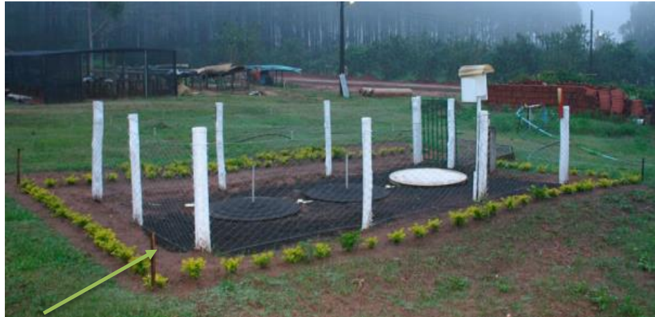
Figura 2: Fossa Séptica Biodigestora.
