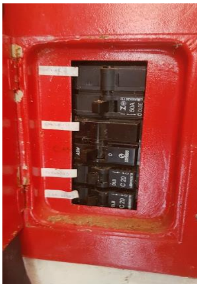
Figura 19: Foto do atual quadro de disjuntores da casa modelo.
