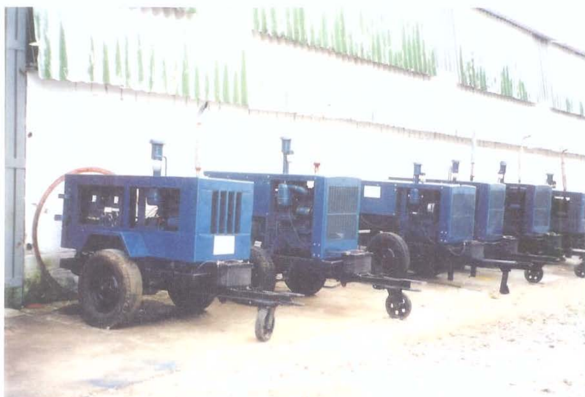
Moto-geradoras Diesel aguardando reforma
