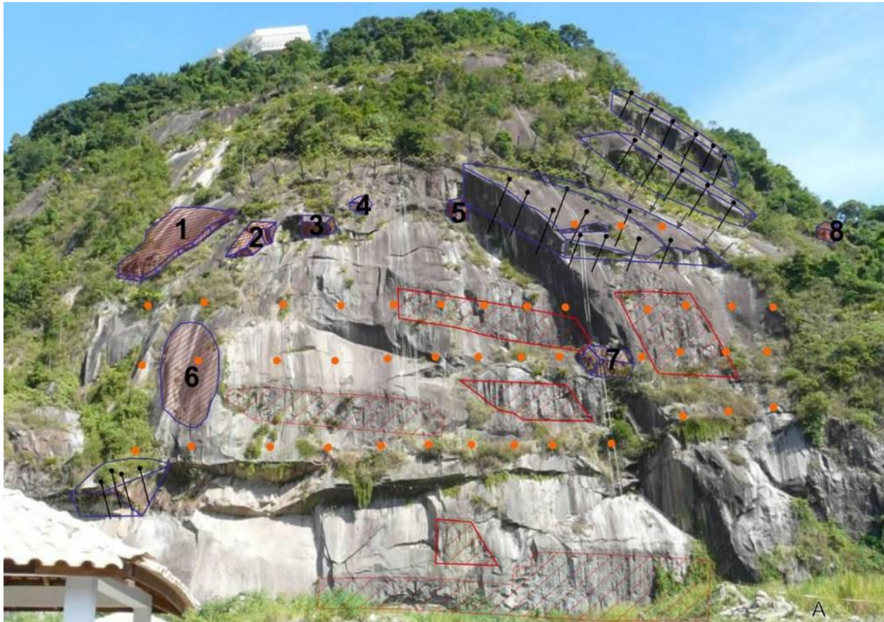
Figura 25. Vista geral da exposição a partir da base. A extensão total do corte é de aproximadamente 100 m. O tratamento sugerido para a encosta do Morro Santa Terezinha inclui remoção física dos blocos de rocha instáveis; uso de tirantes nas lajes de rocha e chumbadores na parede da vertente (Fonte: BUREAU, 2010)
