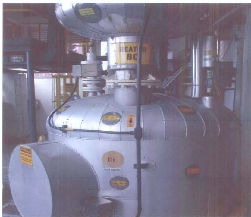
Foto 3: Reator de Branqueamento.
