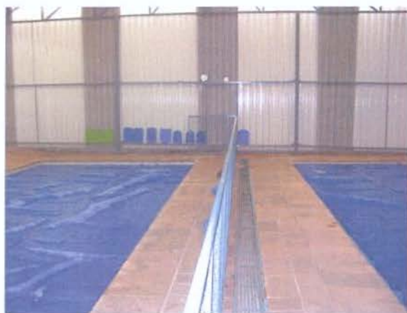
Figura 30 – Sistema de escoamento. (Fotos da autora)
