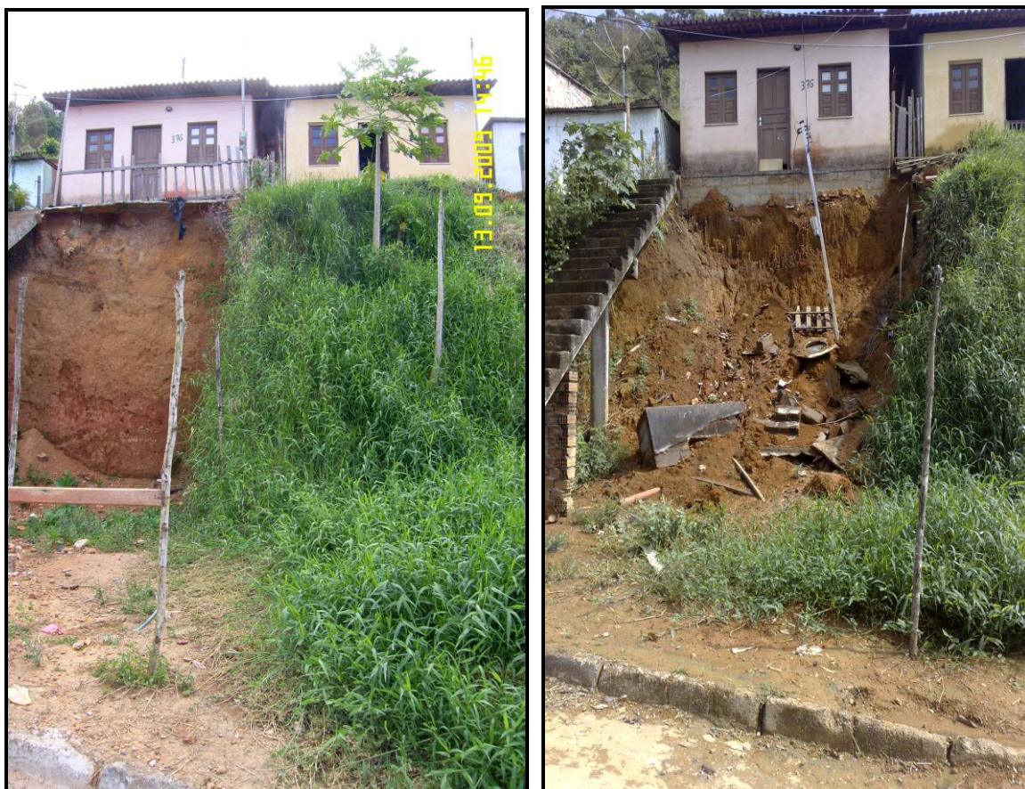
Figura 4.6 - Habitação em área com ocorrência de deslizamento no Bairro Novo em setembro de 2009 (a) e março de 2010 (b) (MATIAS, 2009; FERREIRA, 2010).
