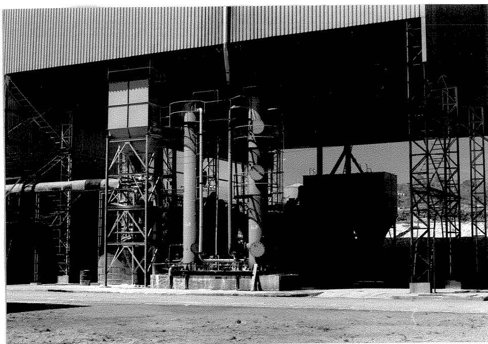
FOTO 4.4 - Planta Química. Unidade de Tratamento Térmico.
