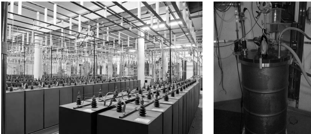
Figura 3.6: Foto do banco de capacitores (esquerda) e do criostato (direita) utilizados nos experimentos em campos pulsados.
