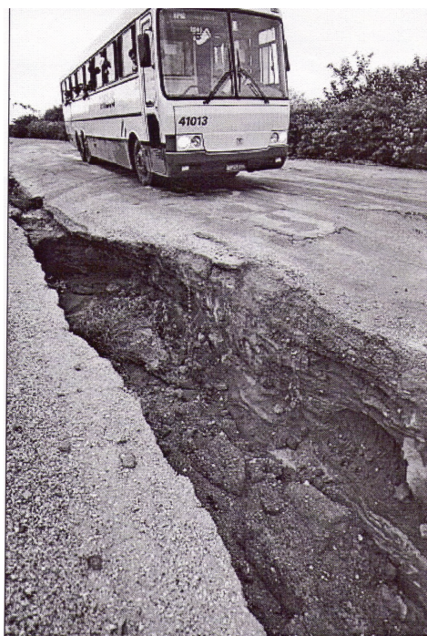
PERIGO NA ESTRADA: uma cratera se abre na BR-020 entre Tauá (CE) e a divisa com o Piauí
