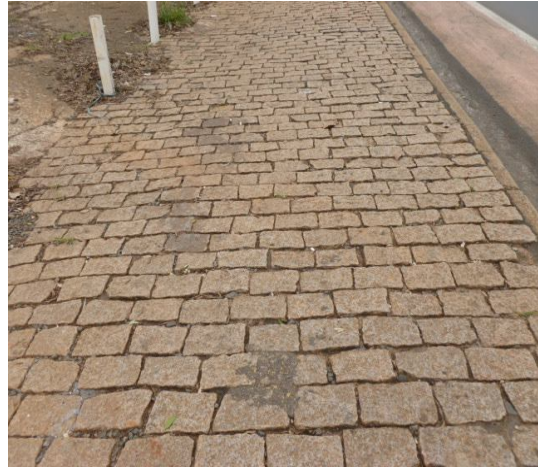
Figura 17 - Inadequação de piso.
