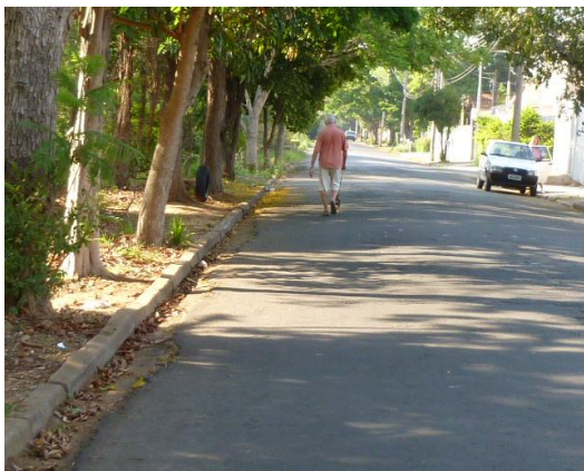
Figura 22 - Inexistência de calçada.
