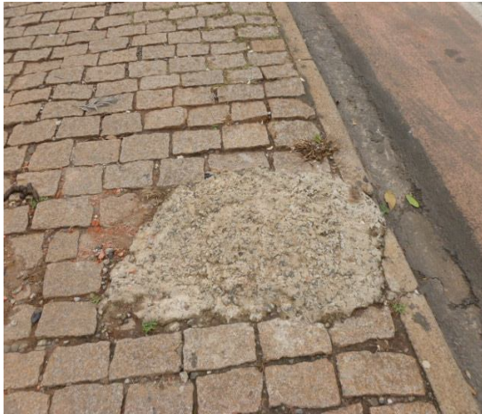
Figura 16 - Inadequação de piso, com remendo.
