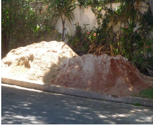
Figura 38 - Calçada com entulho.
