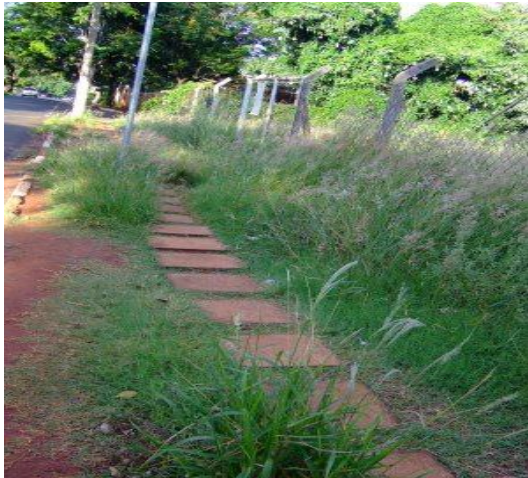
Figura 14 - Inadequação de piso
