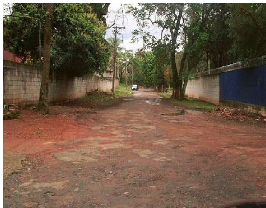
Figura 23 - Inexistência de calçada.
