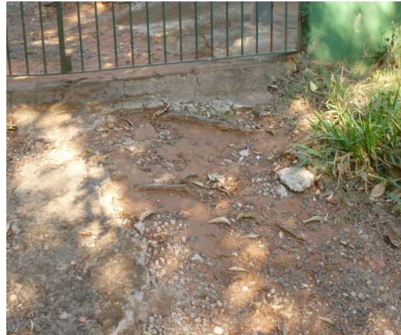
Figura 15 - Inadequação de piso, com buraco.
