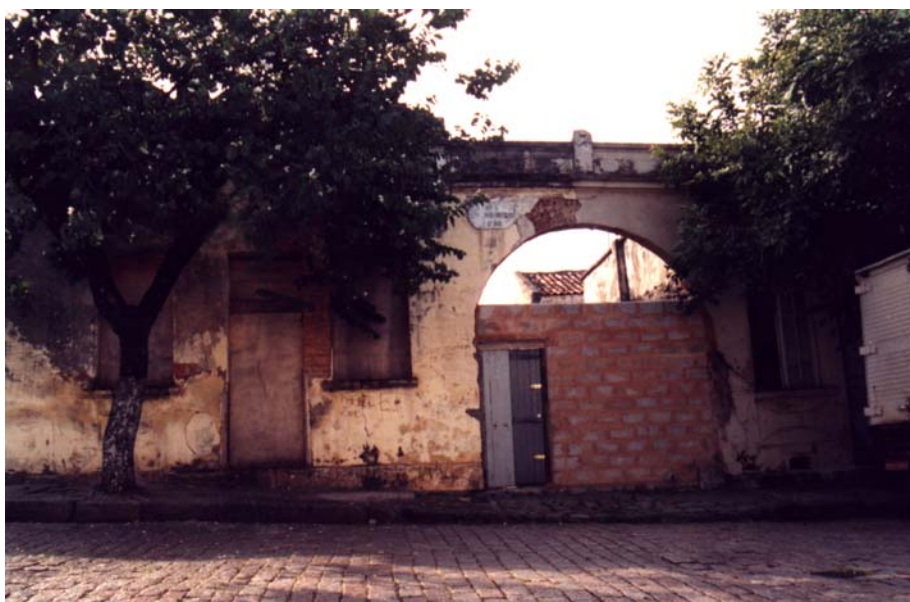
Fig. 13- Devido ao abandono, diversos atos de vandalismo são realizados no interior da Vila Manoel Freire. 59
