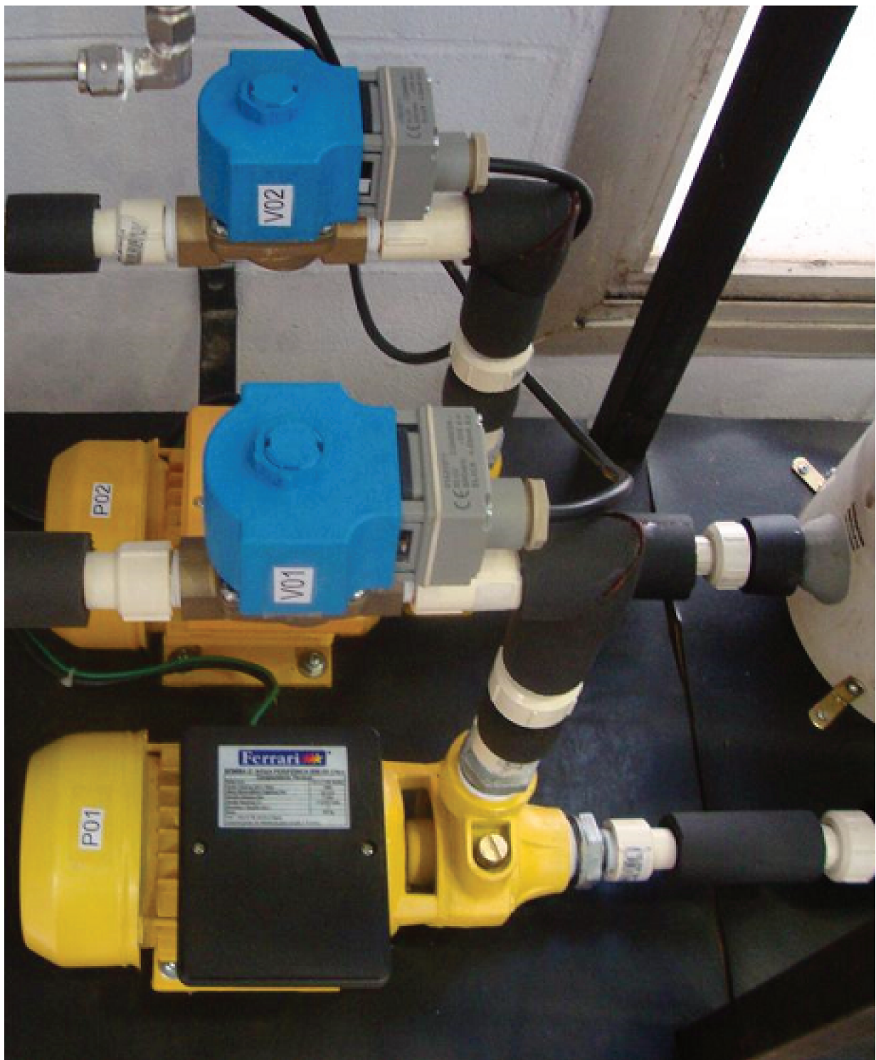
Figura B.3: Válvulas de controle solenóides proporcionais e bombas centrífugas instaladas nas linhas de utilidade.
