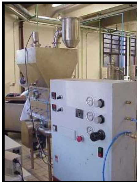
Figura 3.9 - Vista do quadro elétrico com o secador em segundo plano.
