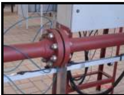
Figura 3.18 - Flange em que se instalou a placa de orifício.
