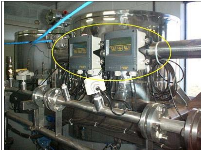
Figura 21– Dois dos três medidores de condutividade elétrica da tubulação secundária, marca DIGIMED, em destaque.
