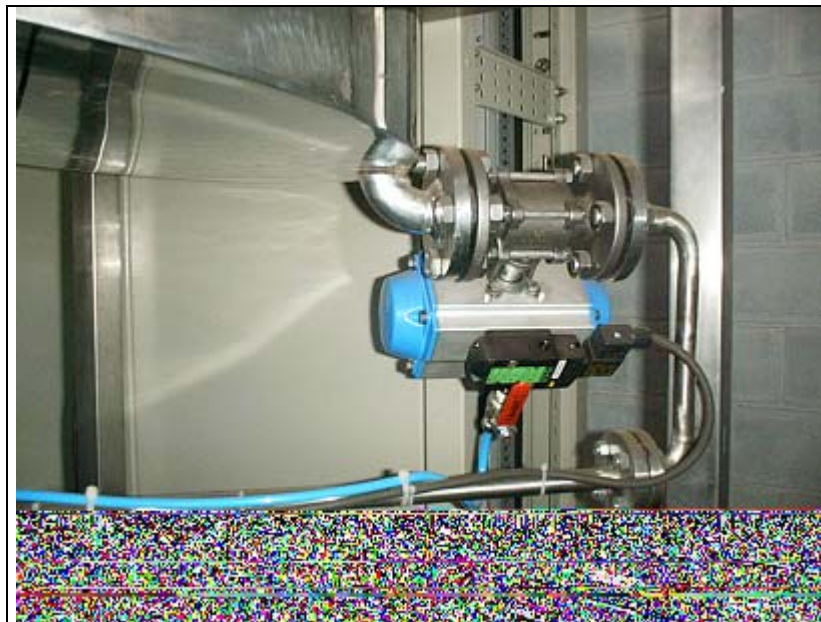
Figura 12 – Tubulação de sucção do tanque componente A, com detalhe da válvula de esfera com acionamento pneumático.
