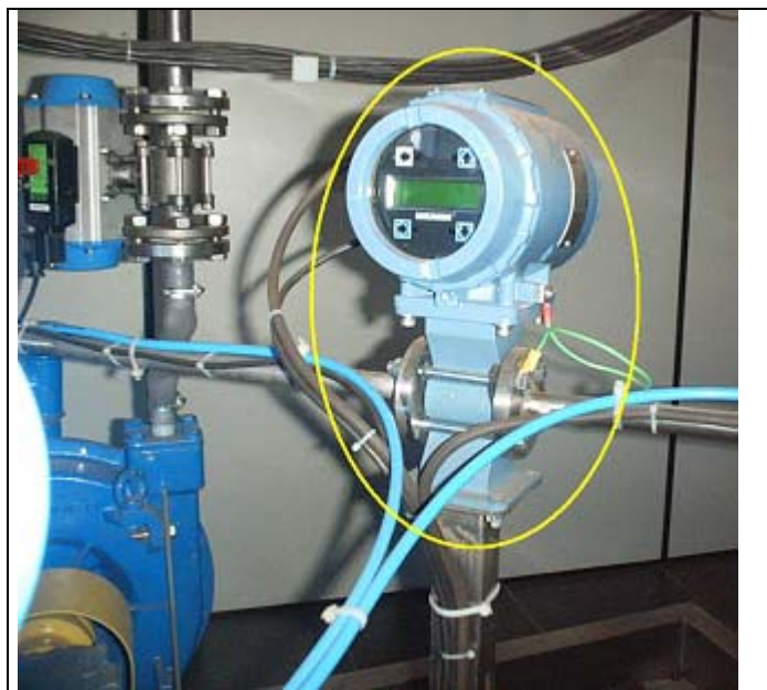
Figura 15 – Um dos três medidores de vazão, marca FISCHER ROSEMOUNT, calibrado para vazão máxima de 400 litros/hora.
