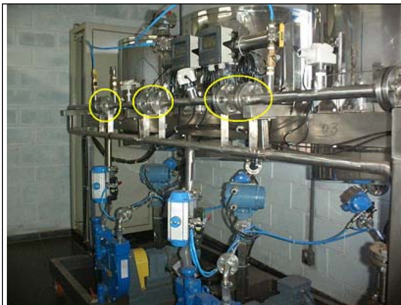
Figura 17 – Vista dos 03 trechos da tubulação secundária onde são inseridos os 03 misturadores estáticos.
