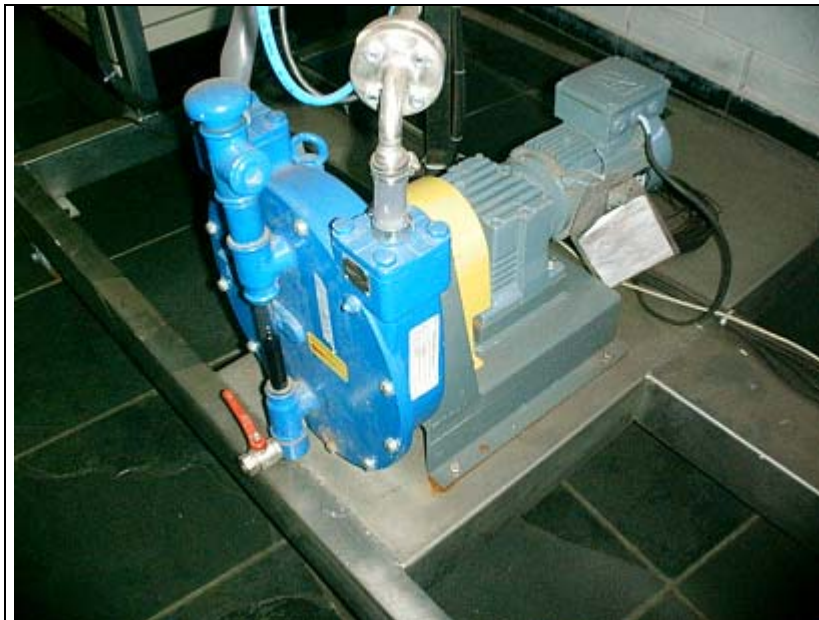
Figura 14 – Uma das três bombas peristálticas ALLWEILER. Detalhe do motoredutor SEW de acionamento da bomba
