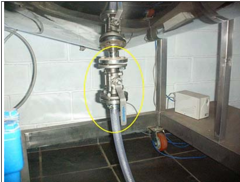
Figura 13 – Válvula de esfera entre flanges no tanque de produto final.
