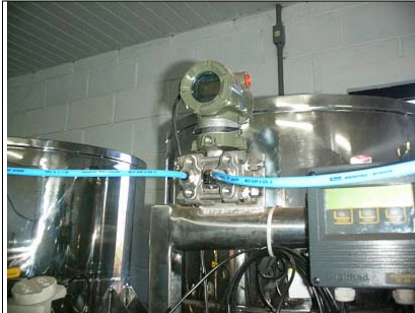
Figura 19 – Medidor de pressão, marca YOKOGAWA.
