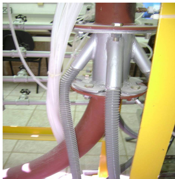
Figura 3.5: Entrada da seção riser da Unidade Multipropósito.
