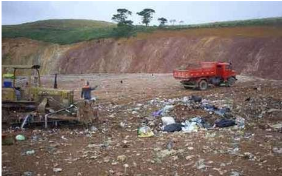
Figura 3.7 – Aterro controlado na cidade de Resende/RJ. (ATERRO CONTROLADO, 2011)
