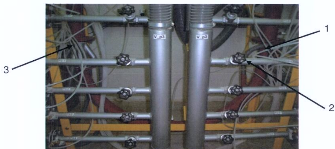
Figura 3.9: Curva em U (1 – saída do downer; 2 – válvulas de alimentação do ar aos bicos de alimentação de ar; 3 – entrada ao riser).
