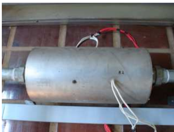
Figura 3.3: Sistema de aquecimento.
