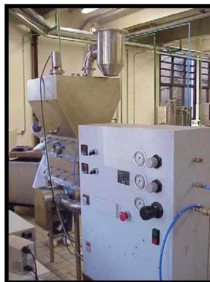
Figura 3.6 –Quadro elétrico com o secador em segundo plano.
