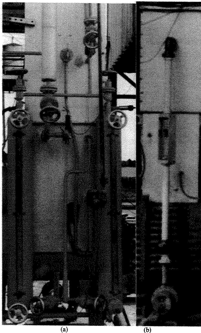
Figura A.9 – Vista do (a) resfriador evaporativo CE-70, destacando-se os reservatórios de amônia e (b) do rotâmetro.
