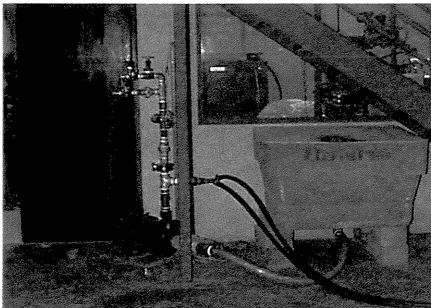
Figura 3.20 - Detalhe do sistema de refrigeração mostrando reservatório e bomba.
