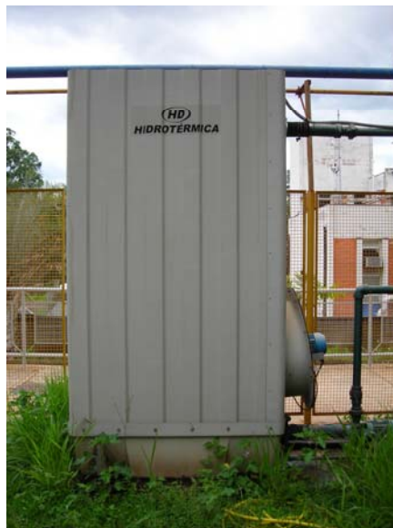
Figura 3-7 Torre de resfriamento
