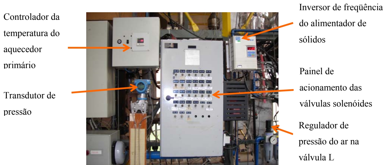
Figura 3-10 Painéis de controle do LFC
