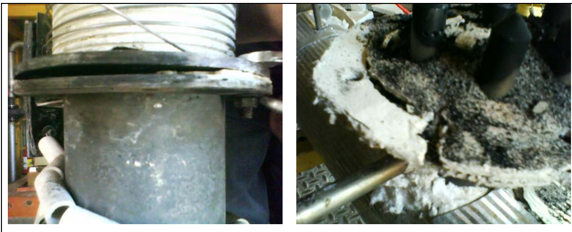
Figura 4.11 – Imagens das juntas de amianto sem condições de utilização.
