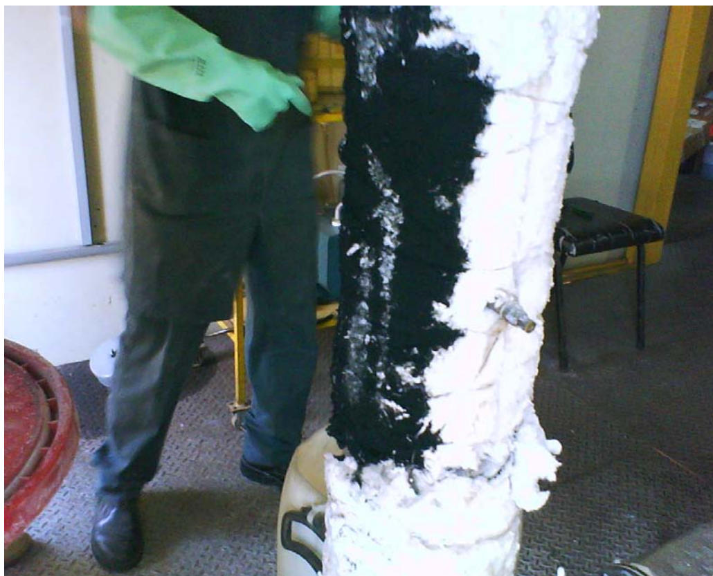
Figura 4.10 – Lã de vidro tingida pela fumaça que vazou do reator.
