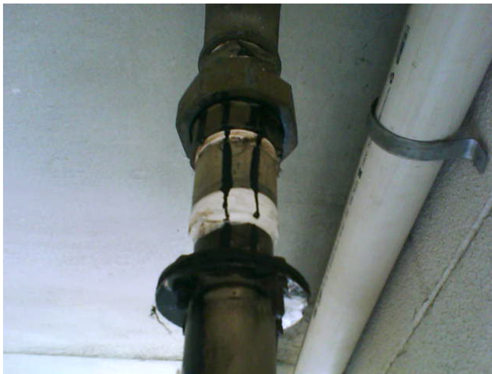
Figura 4.12 – Vazamento localizado nas conexões do sistema de escape do reator.
