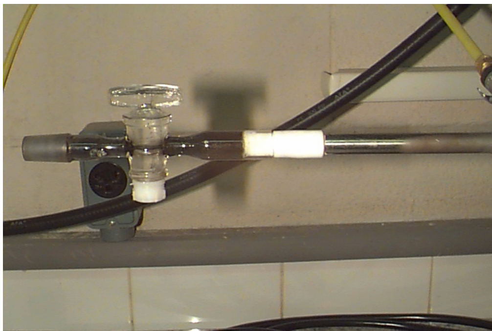
Figura 3.31 Conexão entre tubo de vidro e lança de aço
