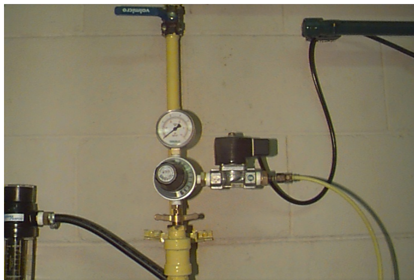
Figura 3.26 Regulador de pressão e válvula solenoide
