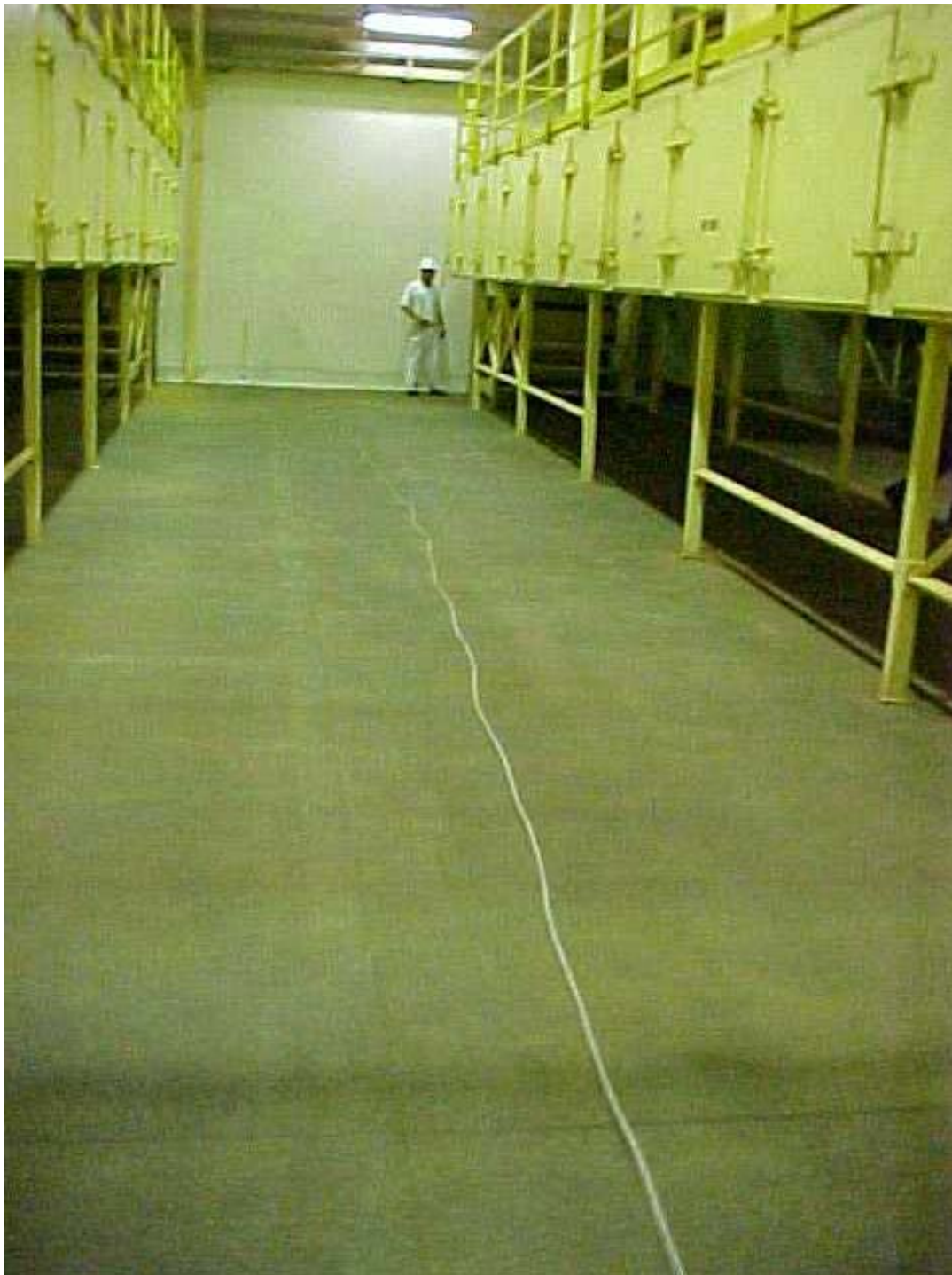
Figura 4.10 : Foto da área de fornos antes das melhorias - Mogi-Mirim 2002
