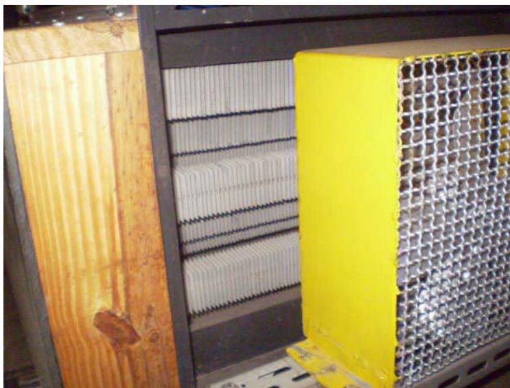
Figura 3.4: Fotografia do conjunto de resistências elétricas na entrada do condensador
