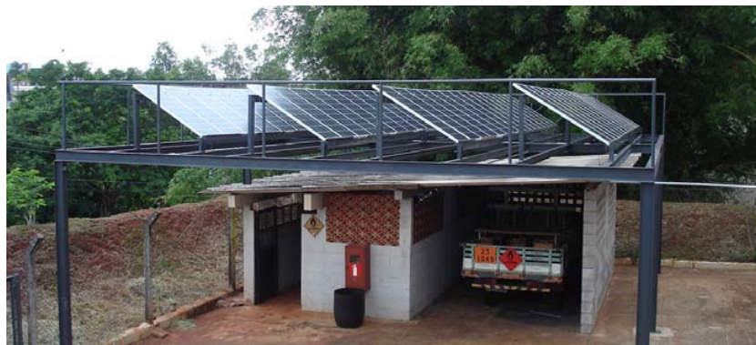
Figura 6.5 Instalação fotovoltaica do Projeto PD-28
