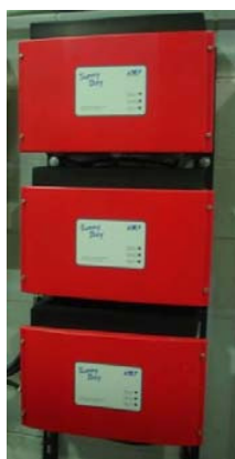
Figura 6.6 Inversores Sunny Boy (SMA) instalados no PD-28
