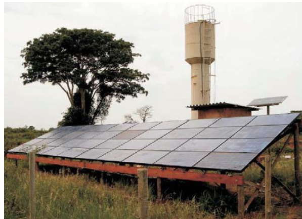
Figura 6.1 Instalação fotovoltaica do sistema de bombeamento fotovoltaico proposto
