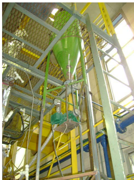
Figura 3-8 Montagem da rosca dosadora no silo.
