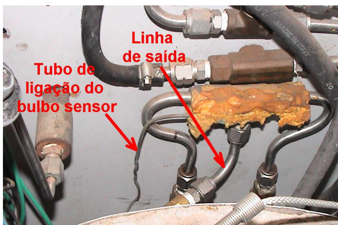
Figura 6.8 – Bulbo sensor do sistema de controle Liga/Desliga do sistema de refrigeração
