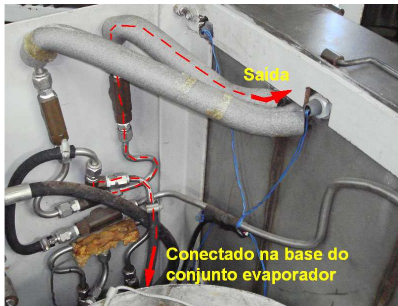
Figura 8.10 - Duto de saída em contato com o ambiente
