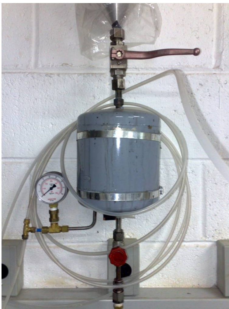
Figura 3.16. Vaso de pressão com manômetro (esquerda), válvulas de entrada de líquido (superior), saída de líquido (inferior) e mangueiras flexíveis.
