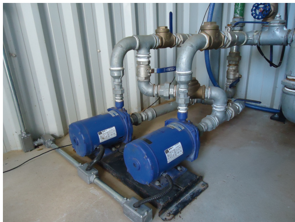
Figura I.3: Bombas do subsistema poço-reservatório.
