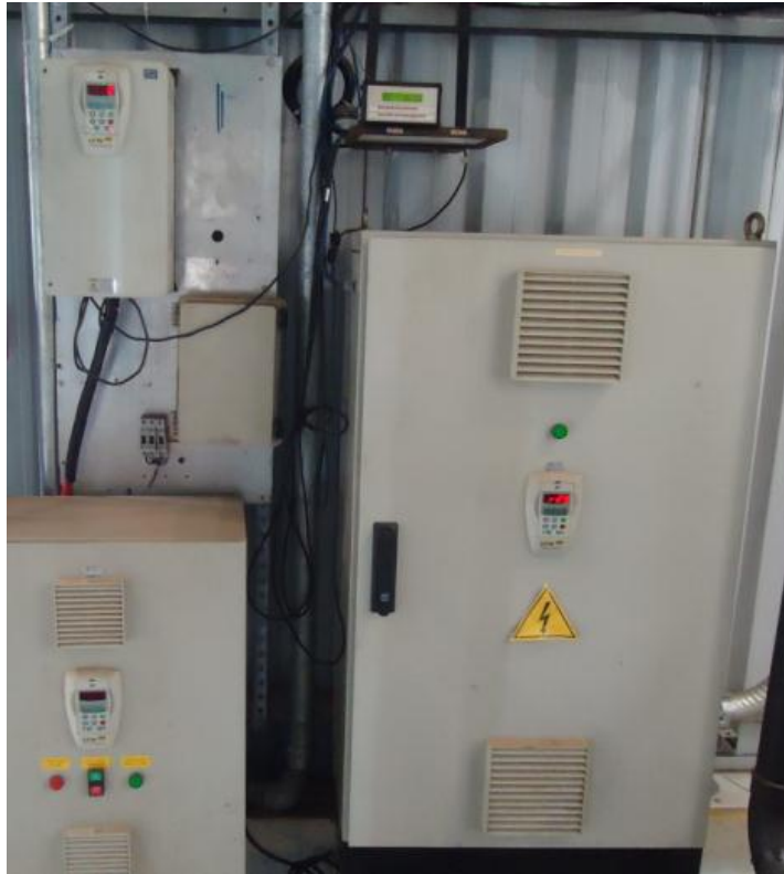
Figura A.V-6. Variadores de velocidades.
