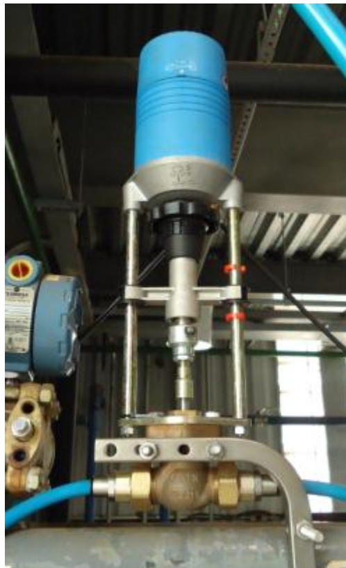
Figura A.V-7. Válvula de controle de vazão de ar.
