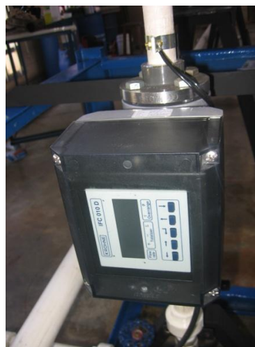
Figura 10 – Medidor eletromagnético de vazão
