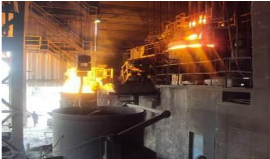
Figura 2.15 Forno elétrico e panela com revestimento refratário. Uso gentilmente concedido pela empresa MWL do Brasil [SYME QUEIROZ, 2011].
