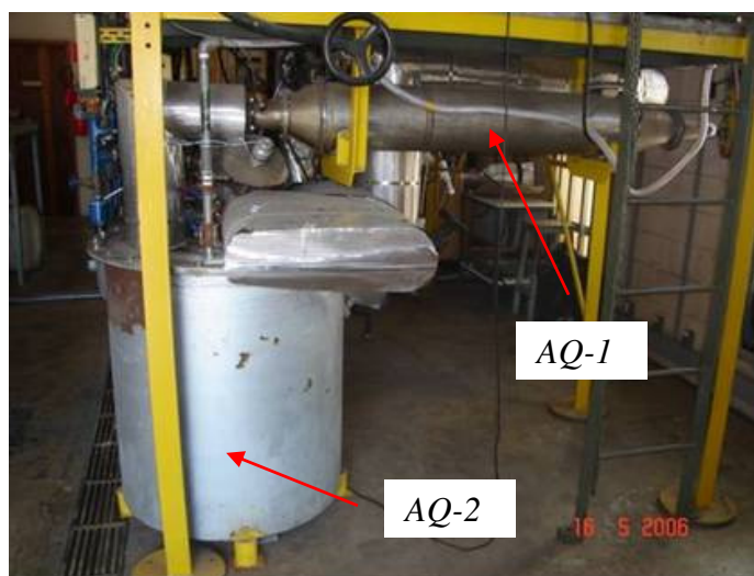
Figura 3-8 Vista geral do aquecedor elétrico ( AQ-1 ) e do aquecedor a GLP ( AQ-2 ).
