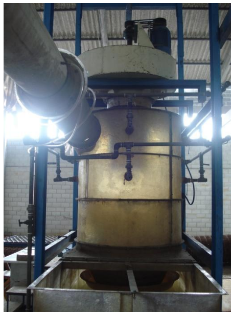
Figura 3.5 – Caixa de contenção e funil de desvio
