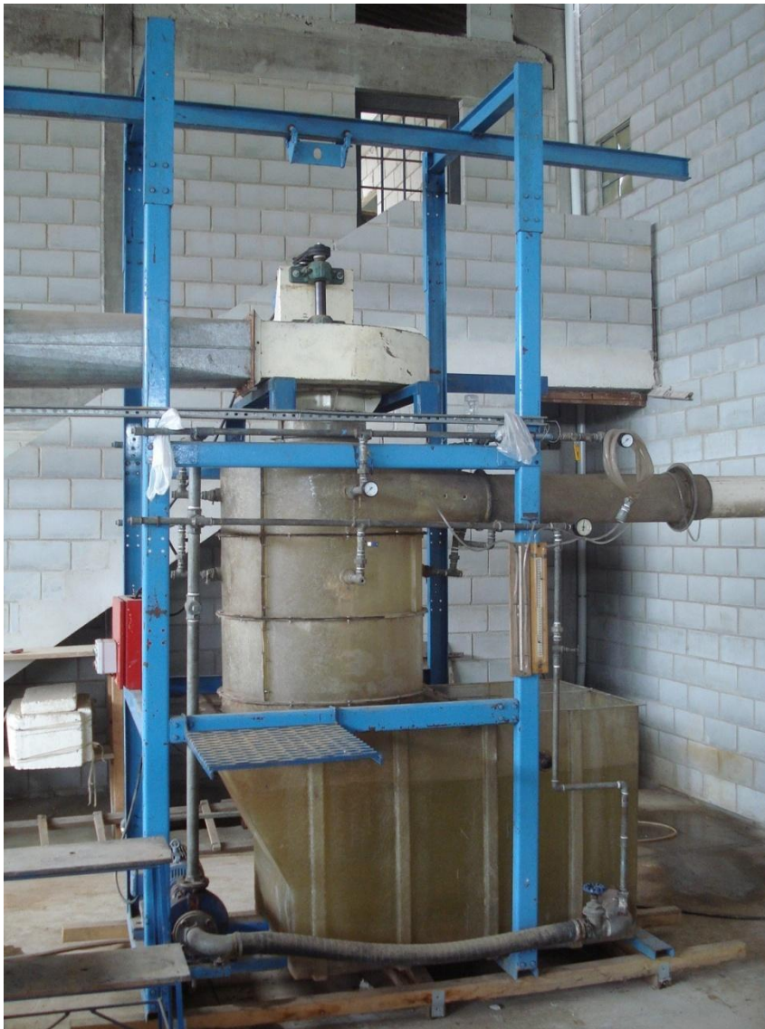
Figura 3.6 – Vista geral do resfriador ciclônico
