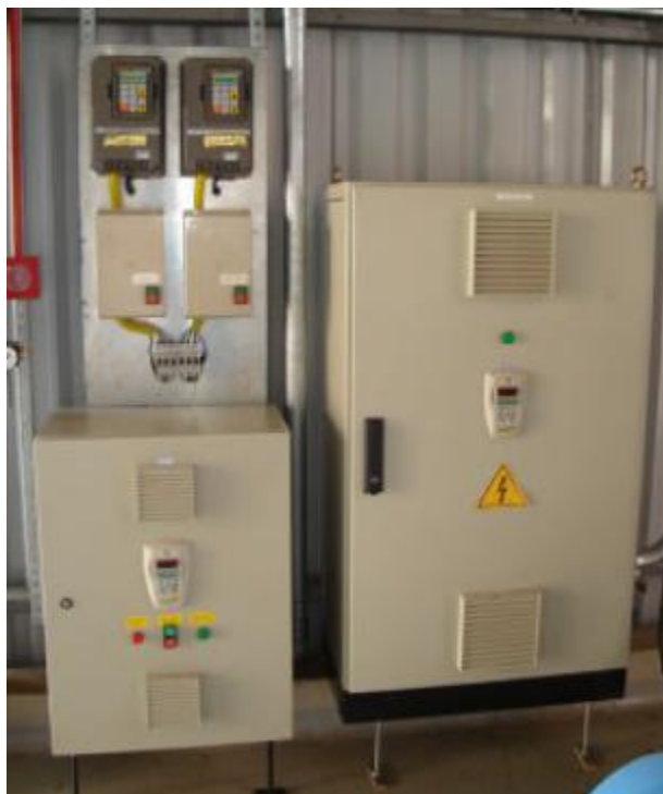
Figura: I.9 - Inversores de frequência.
