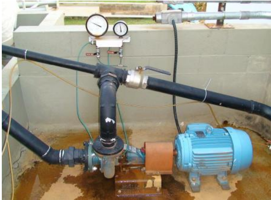
Figura: I.1 - Bomba booster (externa)
