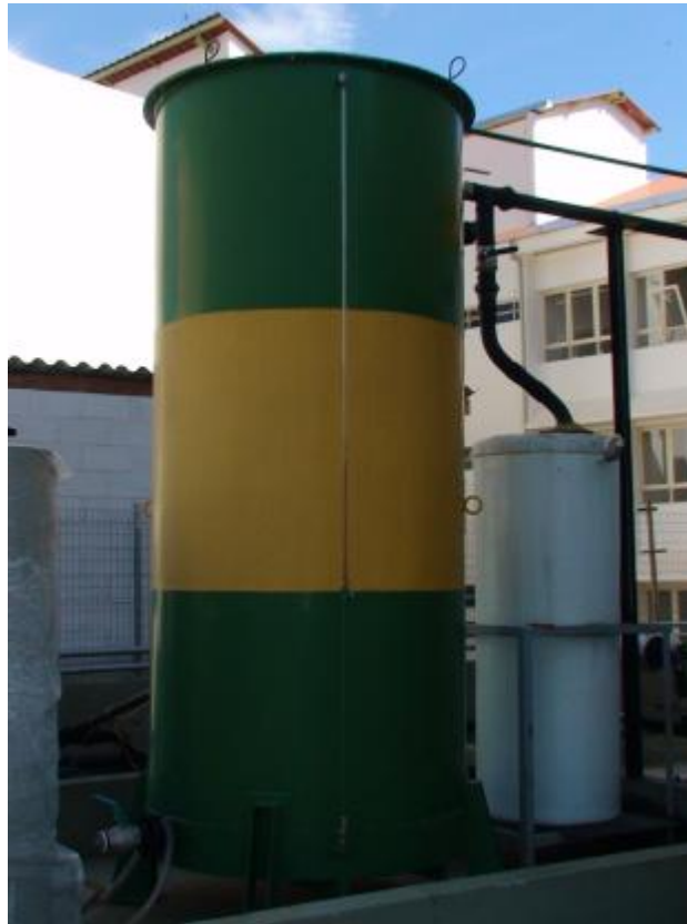
Figura: I.7 - Tanque de armazenamento de água.
