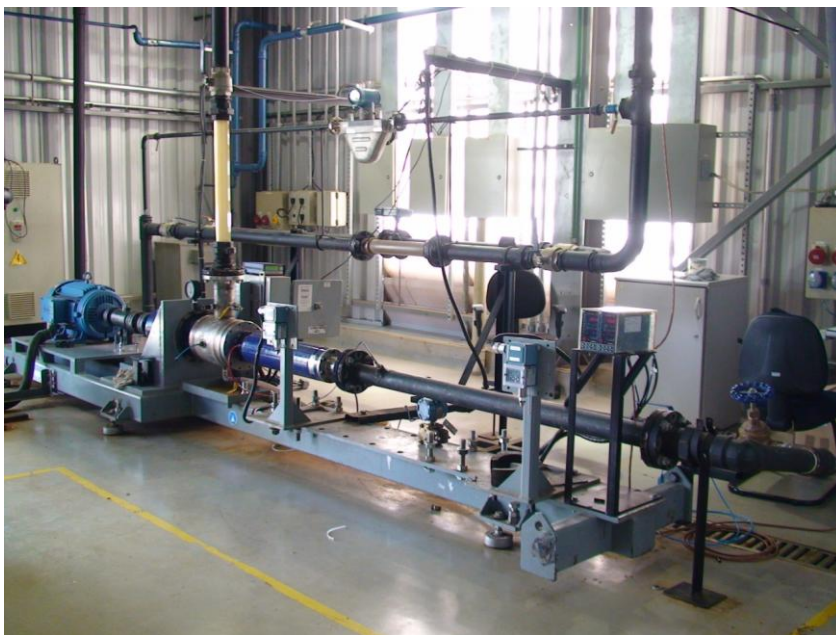
Figura 3.1 - Vista geral da montagem do circuito de testes.
