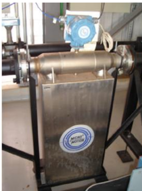
Figura: I.10 - Medidor de vazão mássico.
