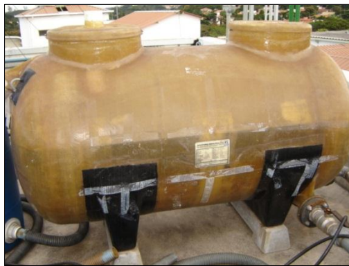
Figura II.2 – Tanque de abastecimento do sistema.
