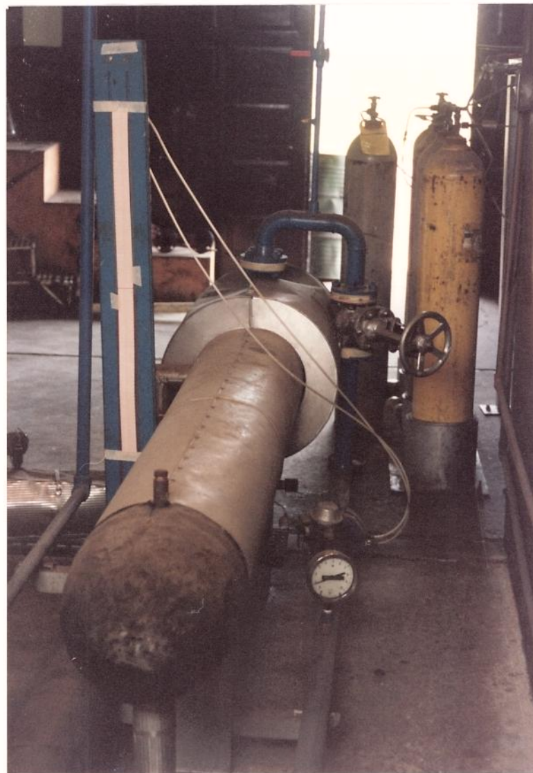
FIG. 2.4. AQUECEDOR A VAPOR, AQ-01
