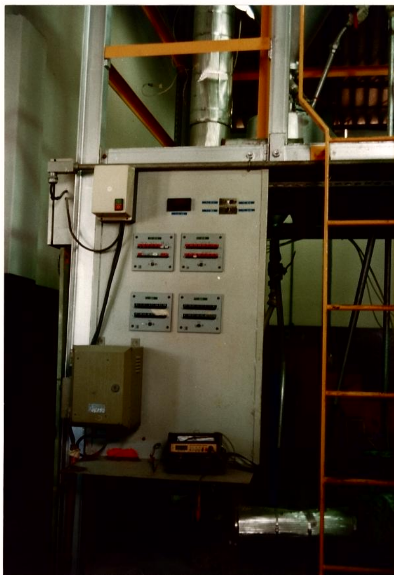
FIG. 2.15. PAINEL DE MEDIDAS DE TEMPERATURAS
