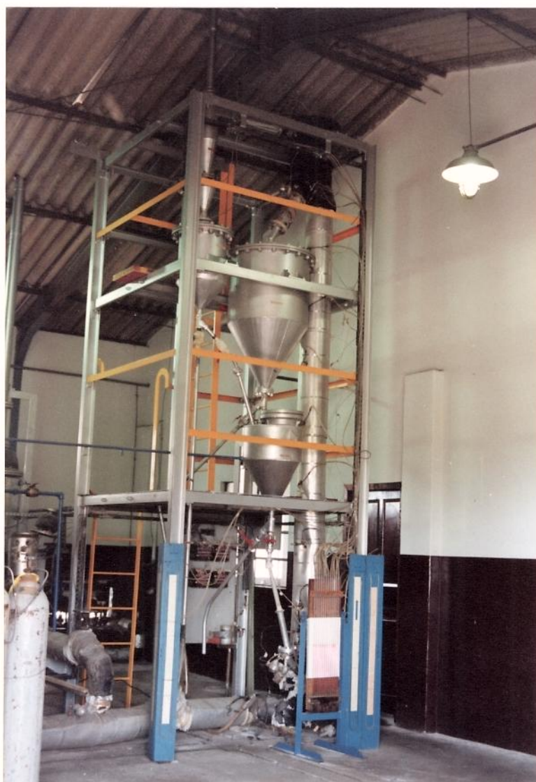
FIG. 2.1. UNIDADE DE TESTES DA TROCA TÉRMICA GÁS-SÓLIDOS NO TRANSPORTE PNEUMÁTICO VERTICAL ASCENDENTE, U-103
