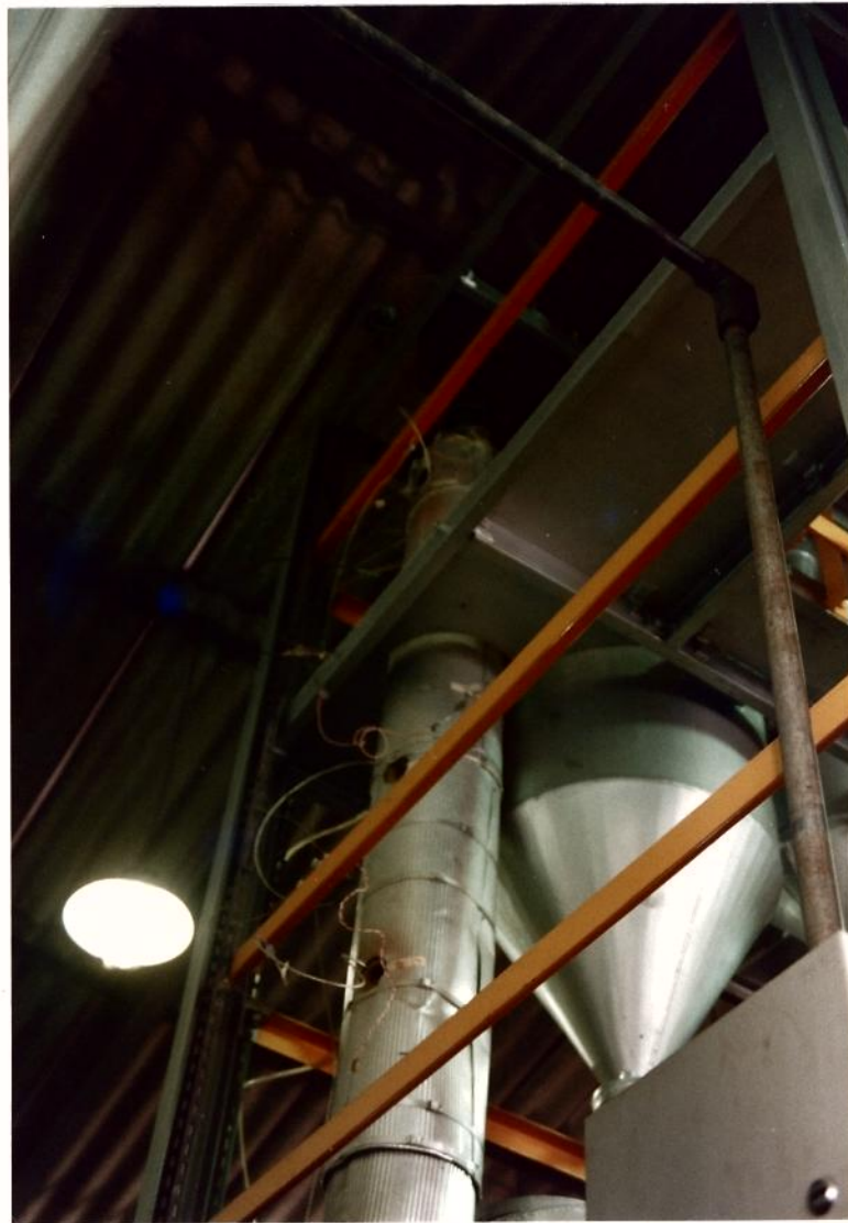
FIG. 2.22. SILO DE COLETA, SI-02 E TUBO DE TRANSPORTE, TT-01.
