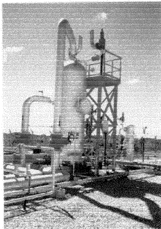
Figura 23: Automação da Planta de Processo - Detalhe do Depurador de Baixa Pressão.
