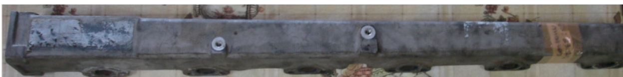
Figura 2.17.2 – Tubulação de água lado superior
