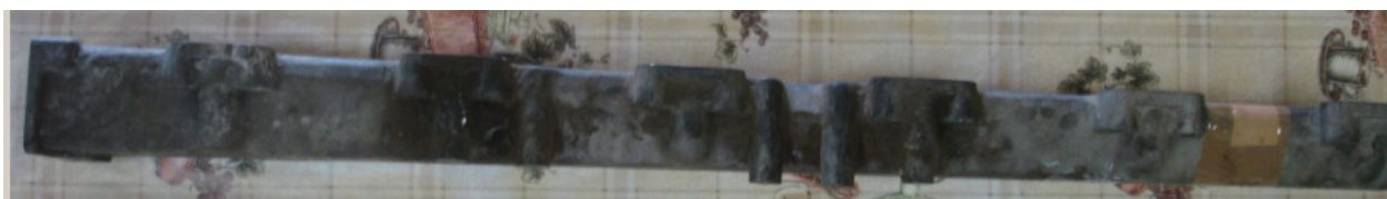
Figura 2.17.4 – Tubulação de água lado inferior
