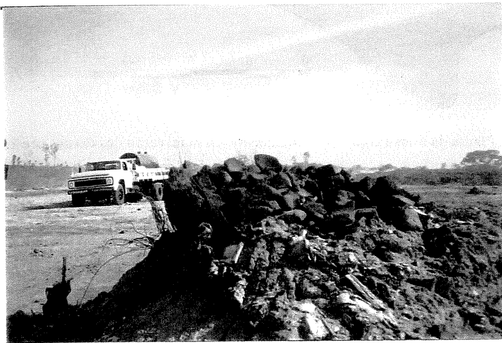
Figura 3.5. Dreno de biogás destruído
