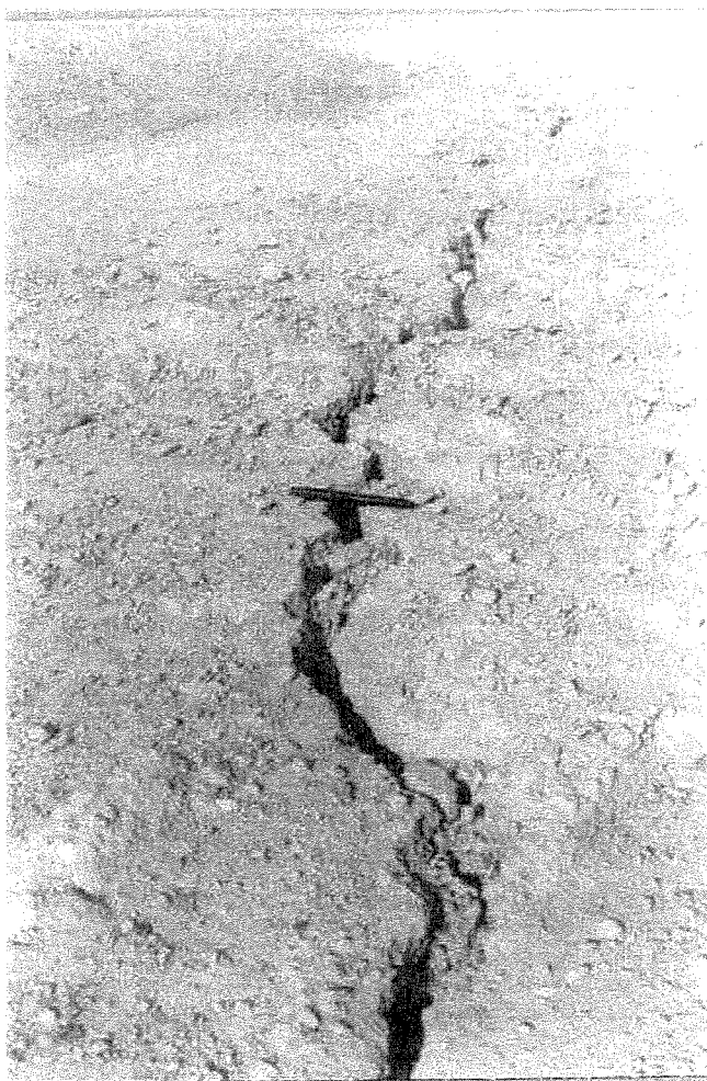
Figura 5.9. Trinca presente no aterro Delta
