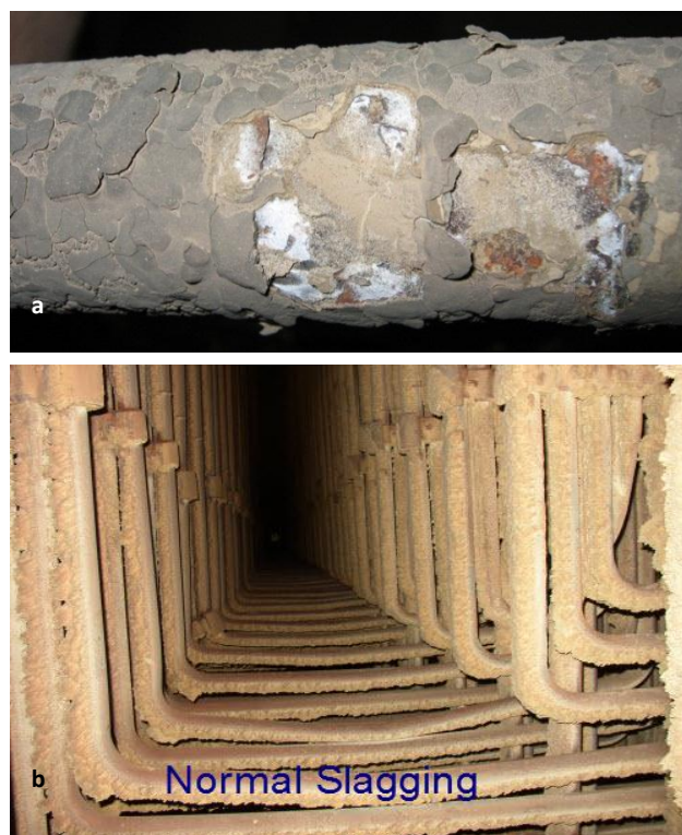
Figura 2.7: Principais problemas de deposições de material em caldeiras e fornos de biomassa: Fouling (superior) e slagging (inferior). (BE SUSTANIABLE, 2013; C4, 2014).
