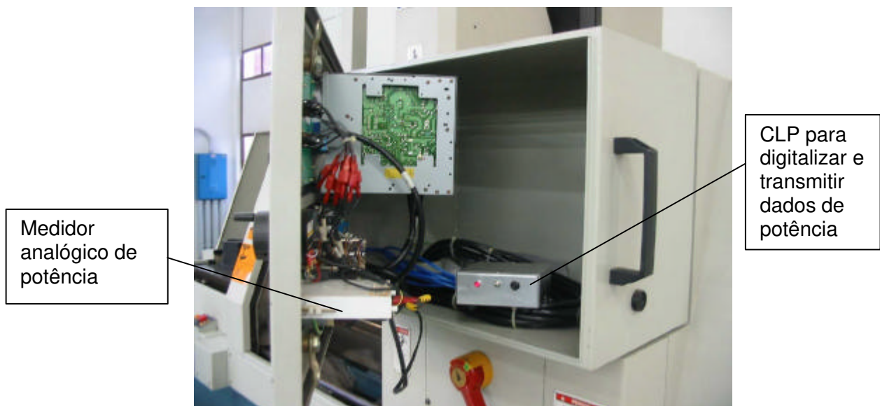
Figura 3.13 - Sistema de coleta digital de potência instalado no CNC
