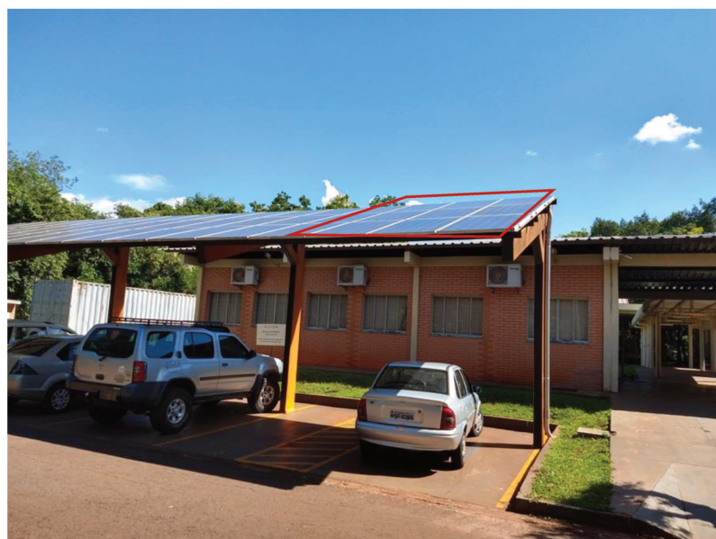
Figura 43 - Painéis fotovoltaicos Sun Earth ® PV-Module 235 Wp.
